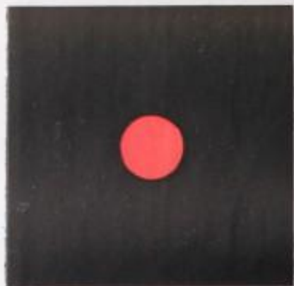
Hueco en el techo
